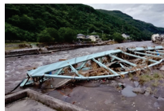
令和2年7月豪雨 大分県日田市の流された橋
