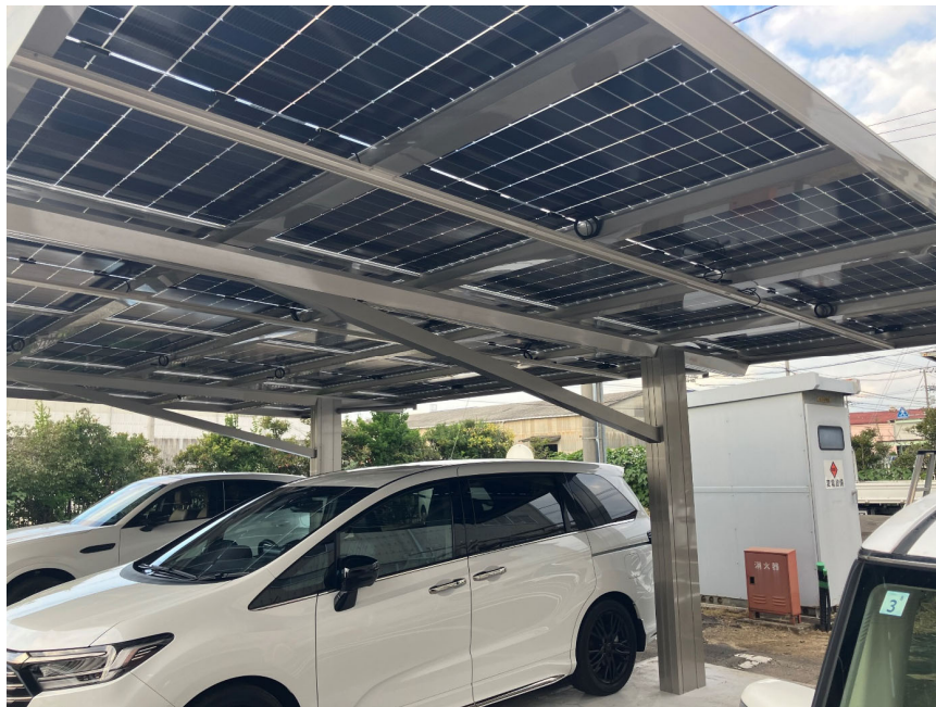
構造部分のボルトが露出しない
