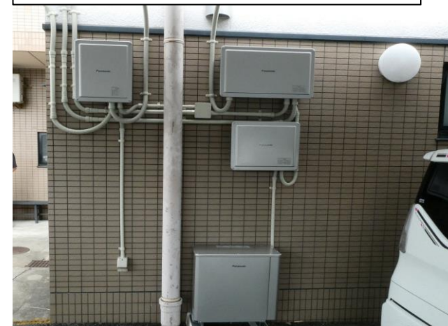
PCS・蓄電池・非常用コンセント
